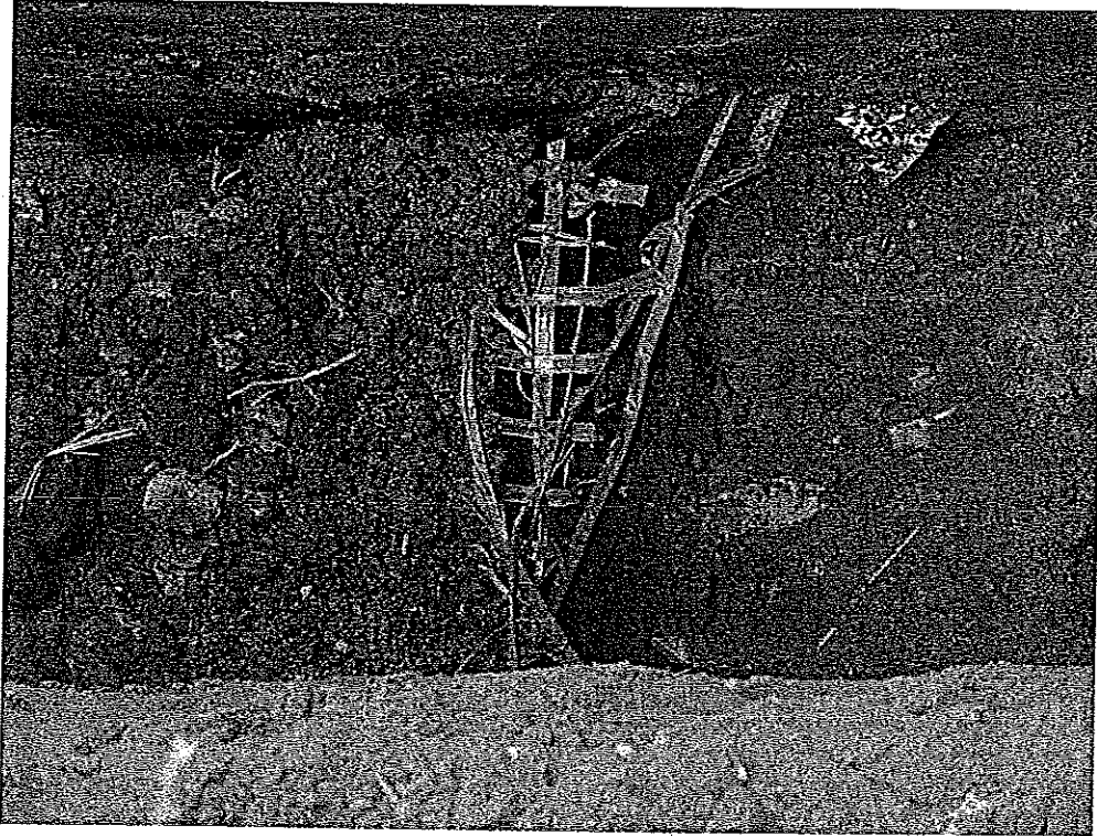
Bild 6: Zustand nach mehrmaligem Baggern
