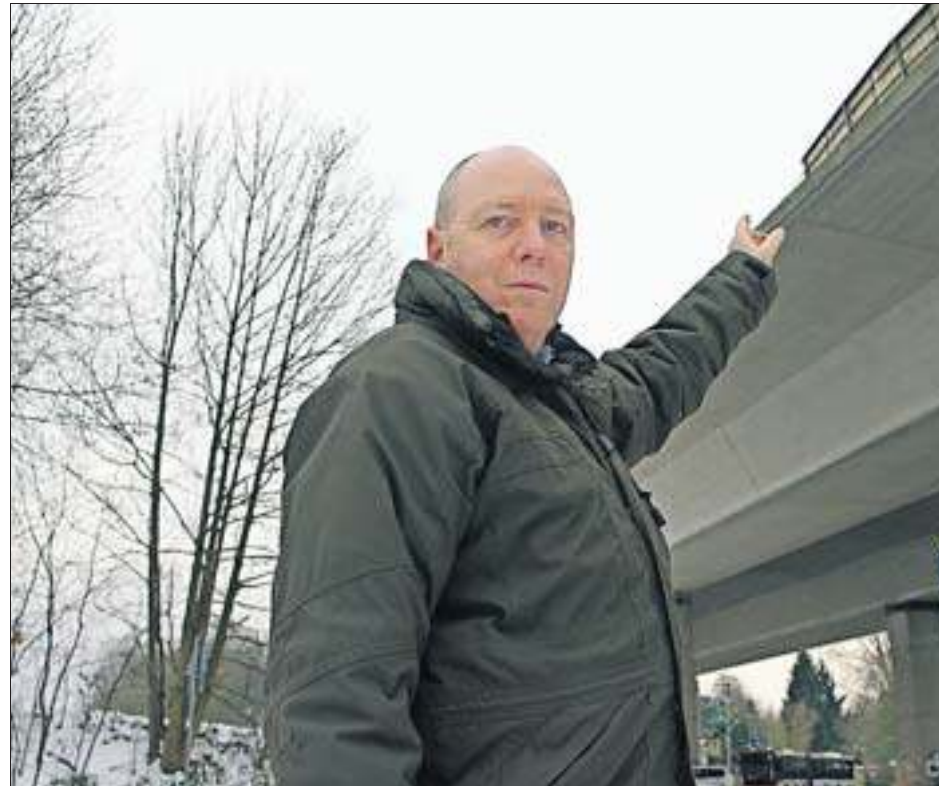
Wolfgang Cüppers von der IG Erkrath zeigt auf die Unfallstelle an der Neandertalbrücke, wo kürzlich ein LKW auf glatter Fahrbahn in die Leitplanke gerutscht ist. Foto: TB
